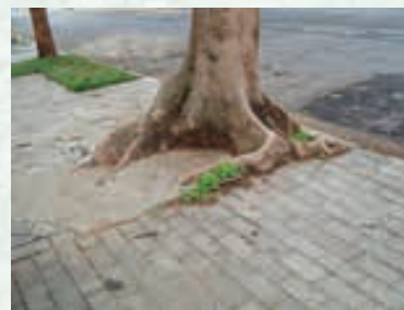
Fig. 20 - Errado: Sufocamento da raiz, impermeabilização e futuros problemas, como quebra de calçada.
